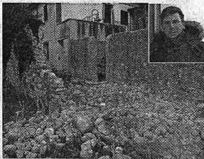
Il muro crollato e nel riquadro il testimone Gjoep Goridan
